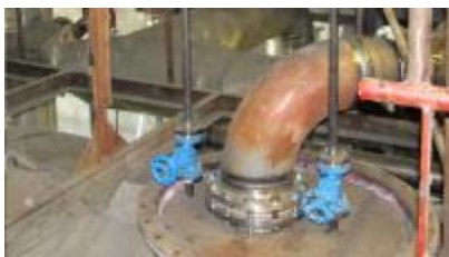
Doprowadzenie wody do odgazowywacza po modernizacji
